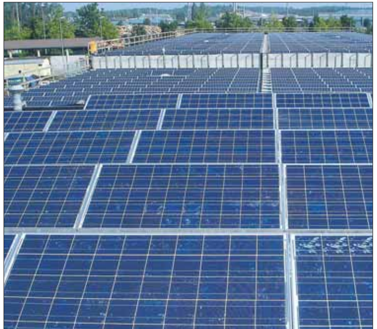
Auf dem Dach der Fahrzeughalle des städtischen Baubetriebshofs wandelt eine (PV)-Photovoltaik-Solaranlage auf ca. 3720 Quadratmetern Sonnenlicht in Strom um. Theoretisch kann diese Anlage über 40 durchschnittliche Vier-Personen-Haushalte mit Strom versorgen. Auch dieses Dach wurde vor der Installation der PV-Anlage neu abgedichtet bzw. saniert.
