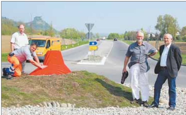
Eine alte Landschaft in leuchtendem Rot: Mitten im Kreisverkehr steht der Leiter der städtischen Abteilung Straßenbau, Erich Müller (rechts). Zusammen mit Michel Leroux (2. von rechts) und Michael Spreitzer (links, stehend) beobachtet er, wie Michael Hildebrand den Mini-Hohenkrähen poliert.
