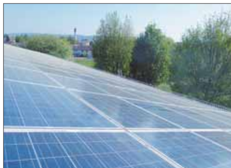
Auf dem Dach des Kindergartens Im Iben wird Strom produziert. Die Photovoltaik-Anlage ist bereits seit vergangenem Jahr am Netz und hat eine Leistung von ca. 39 kWp. Mit dem erzeugten Strom könnte man acht bis neun Vier-Personenhaushalte versorgen.
