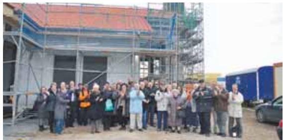
Die Mitglieder der Gemeinde Kirche Jesu Christi der Heiligen der letzten Tage freut sich über ihr neues Gebäude. Im Sommer soll es fertig sein. swb-Bild: cb
