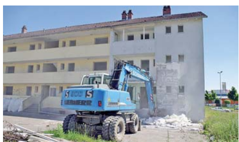
Die Abrissarbeiten an den Häusern in der Singener Franz-Sigel-Straße haben am Donnerstag begonnen. Bereits im Juli starten schon die Bauarbeiten für eine Ley-Großtankstelle. swb-Bild: of
