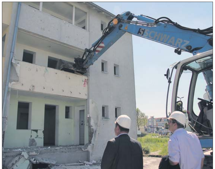
Die GVV will den Brennpunkt Franz-Sigel-Straße entschärfen und Wildwuchs beseitigen. Nachdem mit Spatenstich und Richtfest die ersten Meilensteine für den Neubau in der Fittingstraße 69 a-1 erreicht wurden, haben jetzt die Abbrucharbeiten der Franz-Sigel-Straße 1 und 2 begonnen. Bereits drei Wochen vor dem Abbruch ist der letzte Bewohner aus den betroffenen Gebäuden ausgezogen. Das Grundstück wurde von der Familie Ley erworben, die dort ab Spätsommer eine Tankstelle baut. Diese soll bereits dieses Jahr eröffnet werden. Zudem vermarktet die GVV die bereits geräumte Teilfläche zwischen dem Neubau und dem ehemaligen Kindergarten „Treffpunkt Süd“ als Gewerbefläche.
