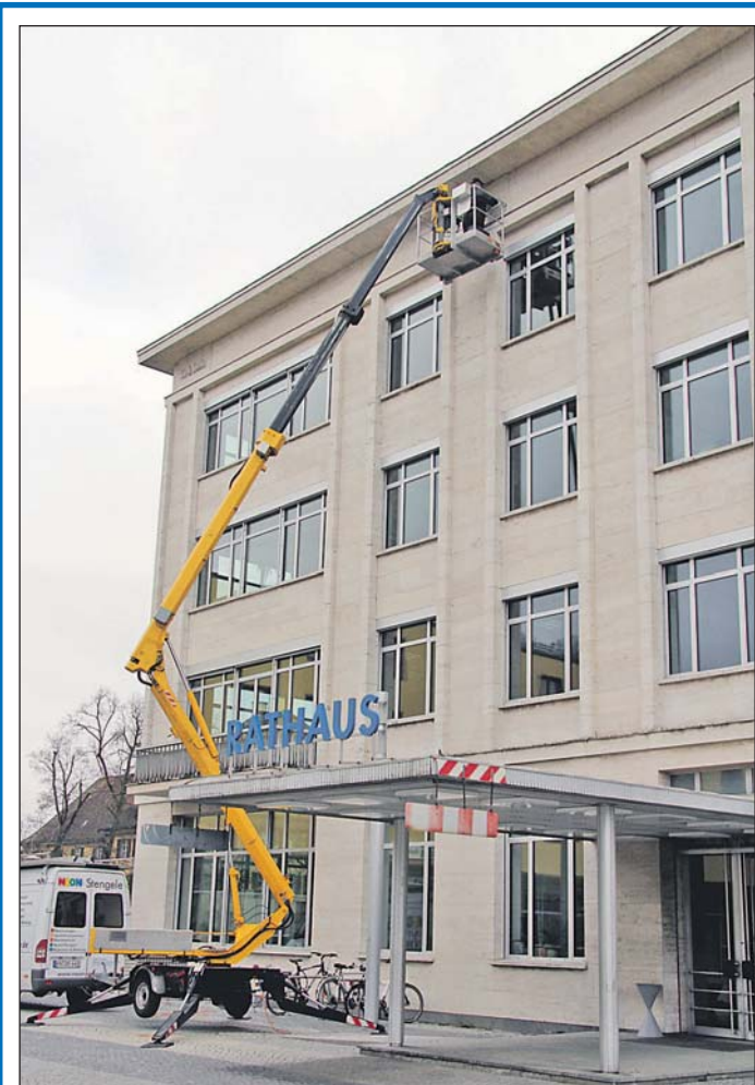
Einige Schriftzüge der Neoninstallation haben mit der Zeit ihre Leuchtkraft verloren: Das auf Dauer am Rathausgebäude angebrachte Kunstwerk „Located World“ (Künstler: Joseph Kosuth) wird teilweise saniert.
