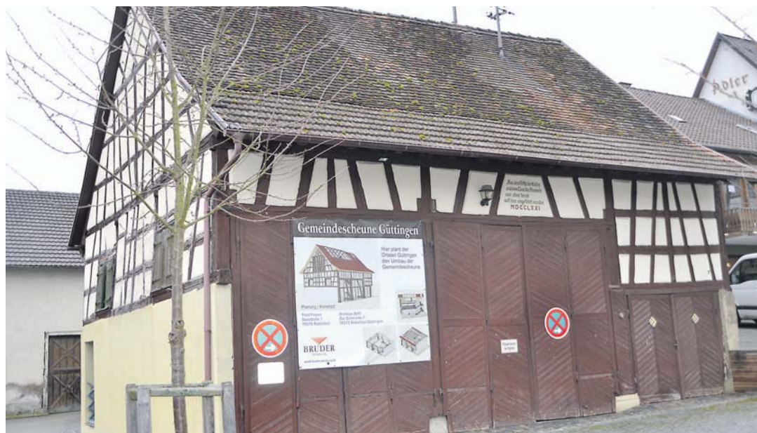
Seit 2010 wartet Güttingen darauf, dass die Gemeindegemeinschaft saniert werden kann. Nach der jüngsten Gemeinderatssitzung könnte nun endlich Bewegung in die Sache kommen. swb-Bild: Archiv/gü
